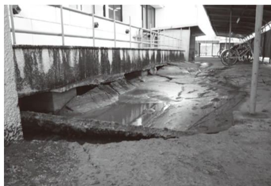
東日本大震災により液状化した市役所駐輪場
