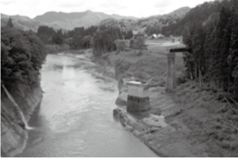
落橋したJR只見線第7橋梁
