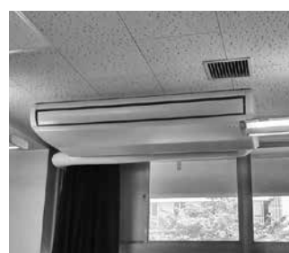
中学校の特別教室・設置済みのエアコン
