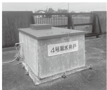
第2浄水場の4号取水井戸
