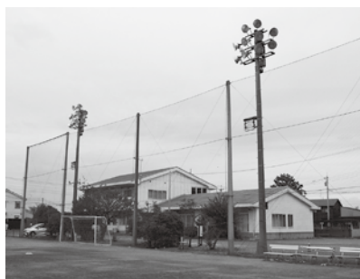
公民館グラウンドの夜間照明施設
